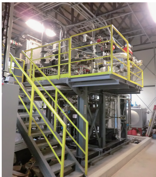
実証施設内部の発電システム
