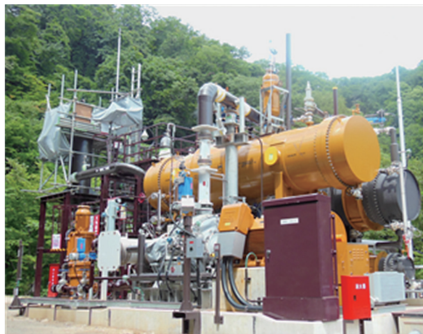
（上）土湯のバイナリー型発電機と見学者の様子
