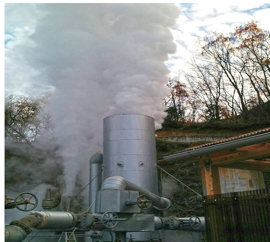
(上) 稼働中のわいた地熱発電所
